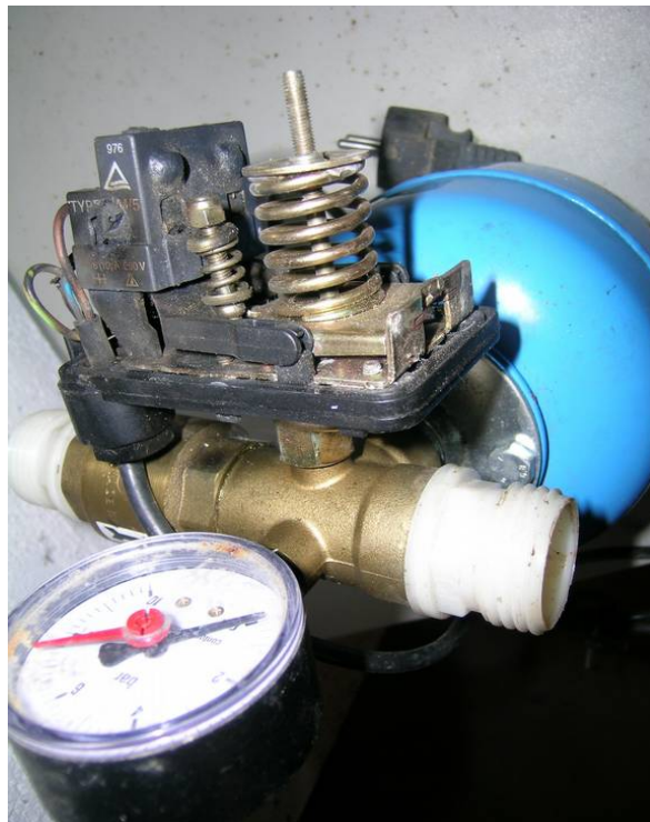
commutateur détruit, on voit les boursoufflures
